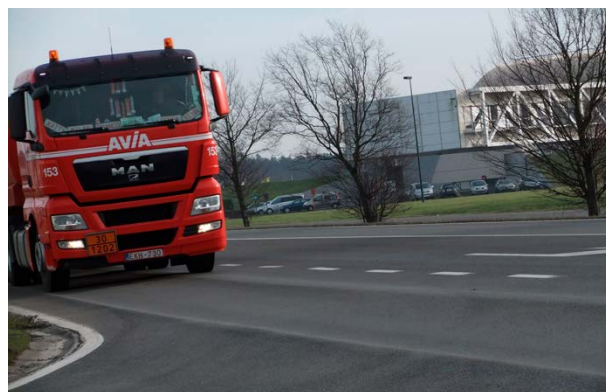
Ernstige spoorvorming op een asfaltweg, te wijten aan zwaar verkeer en versneld door hoge omgevingstemperaturen © FEBELCEM
