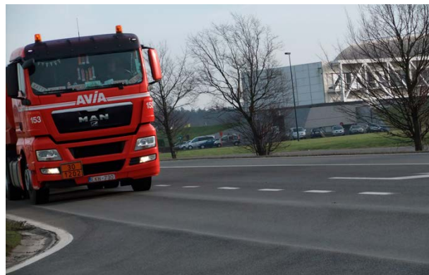
Chaussée en asphalte fortement orniérée, due à un trafic intense et accélérée par des températures ambiantes élevées © FEBELCEM
