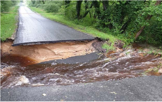
Route endommagée après une inondation, Gironde (France) Page Facebook de Noaillan
