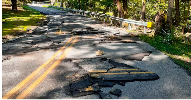
Route endommagée par les eaux de crue, Reading Drive, PA (USA) © Rich Hawk / sauconsource.com
