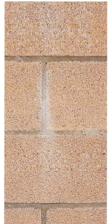
4 - Secundaire uitslag ter hoogte van slecht gedichte verticale voeg
