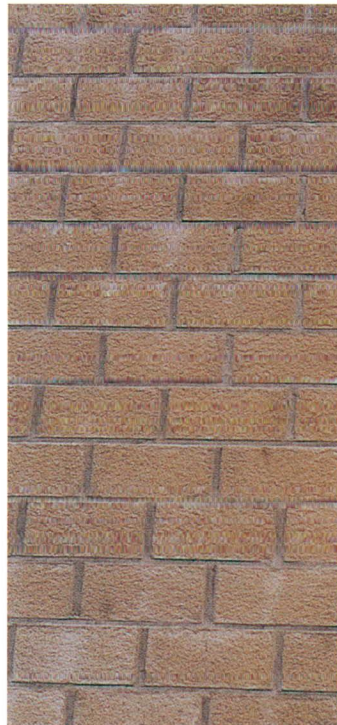
2 - Primaire (en/of secundaire) uitslag op metselwerk
