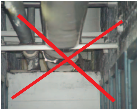
De EI-wand is niet opgemetseld ter hoogte van een leidingdoorgang [22]
