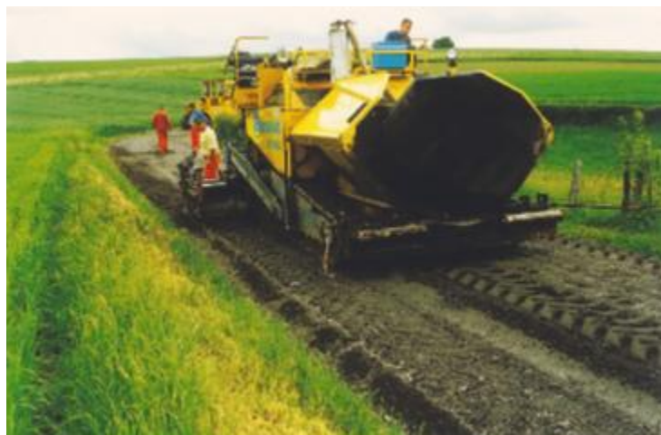
Grove nivellering vervangen door homogenisering met 'finisher'.
