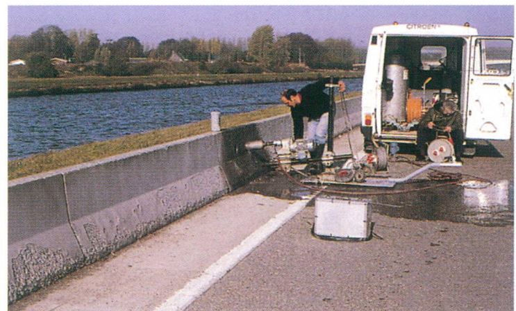
Inwerking van dooizouten op betonnen voertuigkering van het type 'New Jersey' - Proefkernen worden genomen voor analyse
