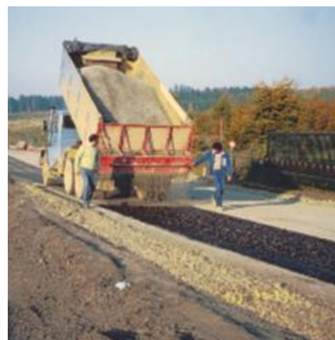
Protection contre la dessiccation par application d'une émulsion de bitume et sablage.
