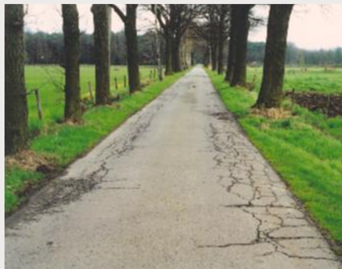
Exemple de route asphaltique à rénover.
