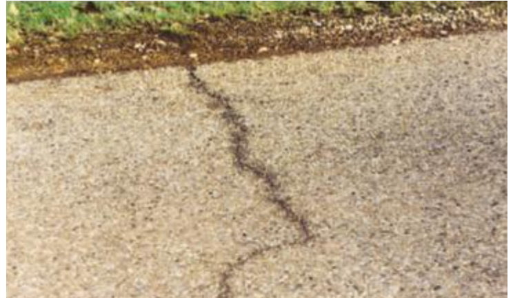
Les remontées de fissures peuvent être maîtrisées sur les routes à faible trafic.
