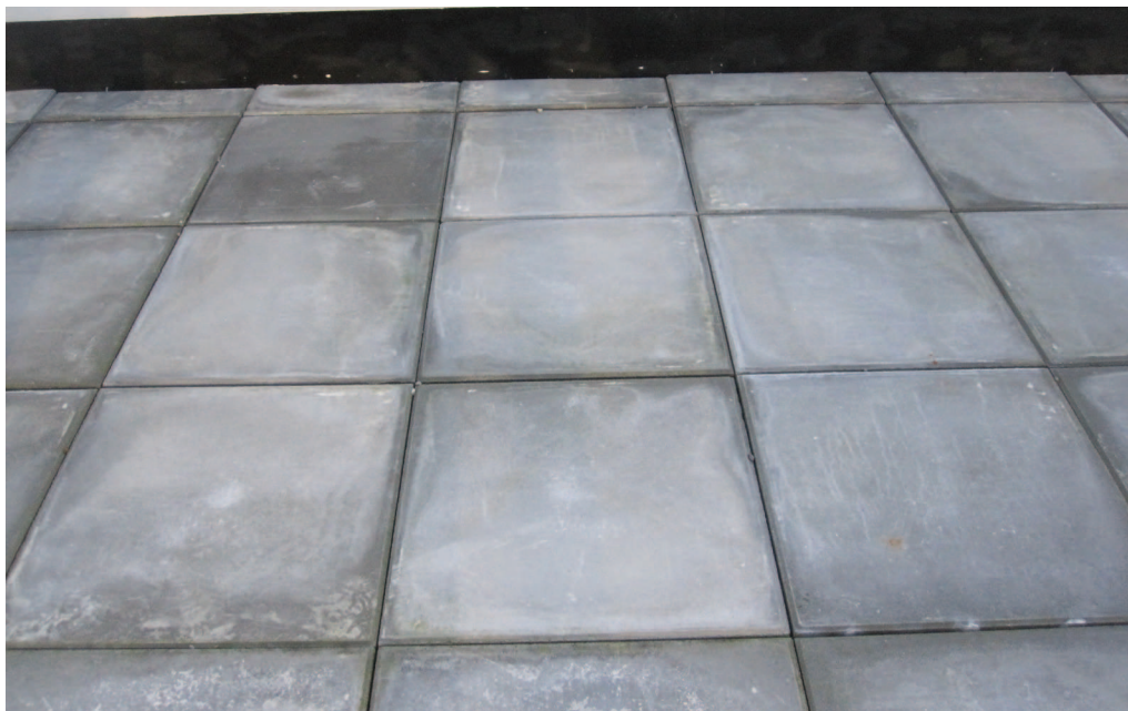
Kalkuitslag op zwarte geprefabriceerde betontegels
