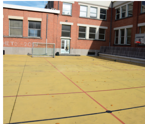
Dezelfde verharding na verdwijnen van de vlekken (Foto's : Bart Helincks, Cathay)
