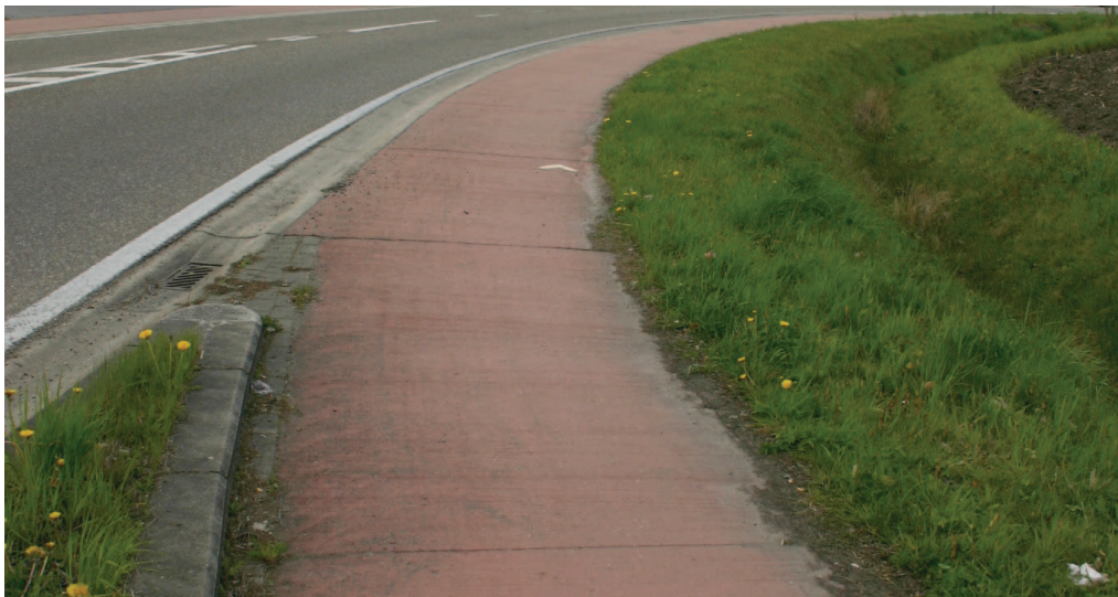
Vervuild betonoppervlak van een fietspad
