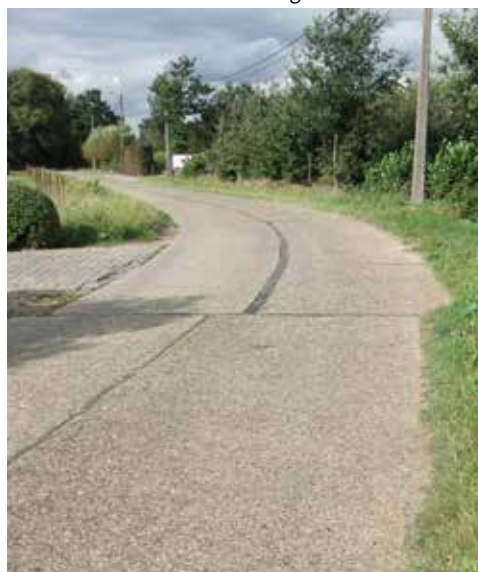
Glissement et ouverture du joint longitudinal en l'absence de barres d'ancrage
