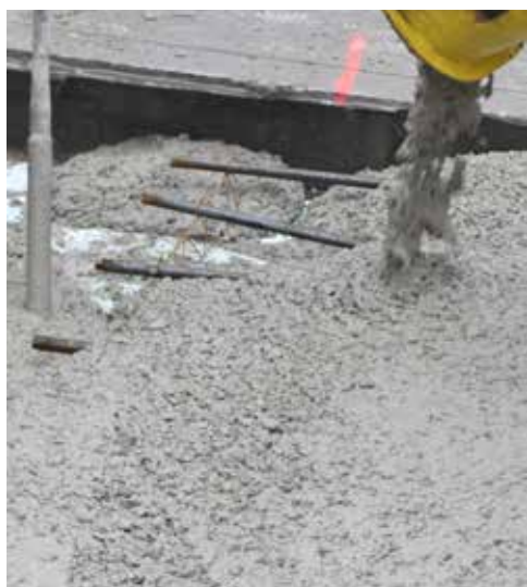
Exemples de mauvais goudjons (corrosion, bavures) et berceaux inappropriés (déformation sous le poids du béton, déplacement des goudjons)
