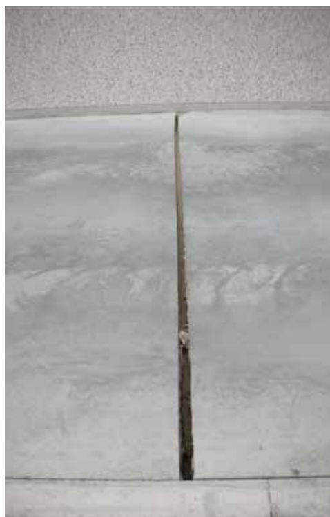
Ouverture d'un joint due au glissement de la dalle sur la feuille de plastique (photo Anne Beeldens)
