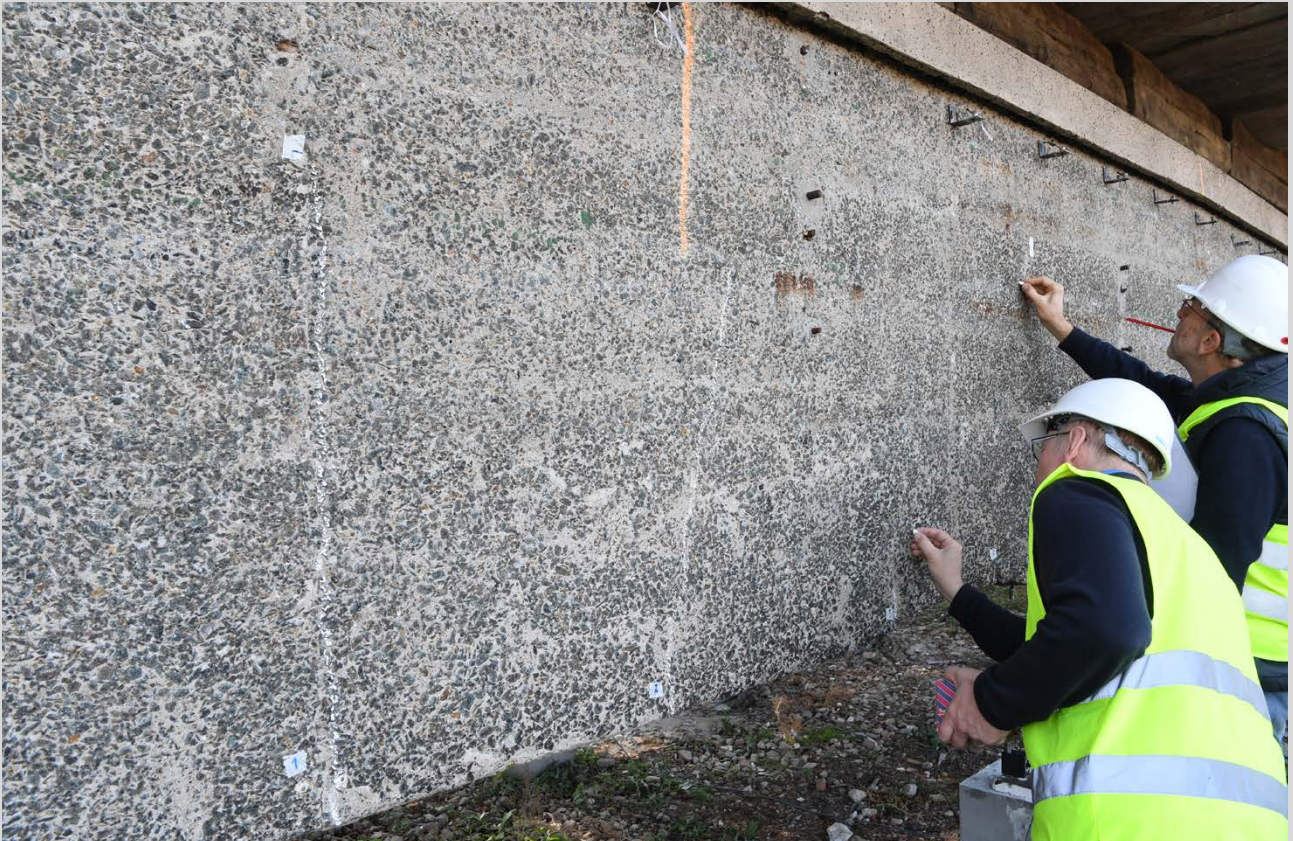
Aanduiding in krijt van de scheuren op de zijkant van een van de liggers.
