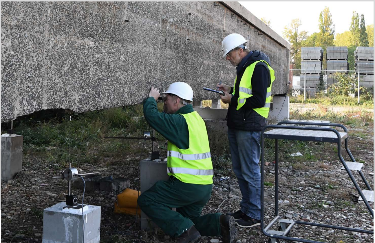
Meting van de scheuropening aan de zijkant van een van de liggers.
