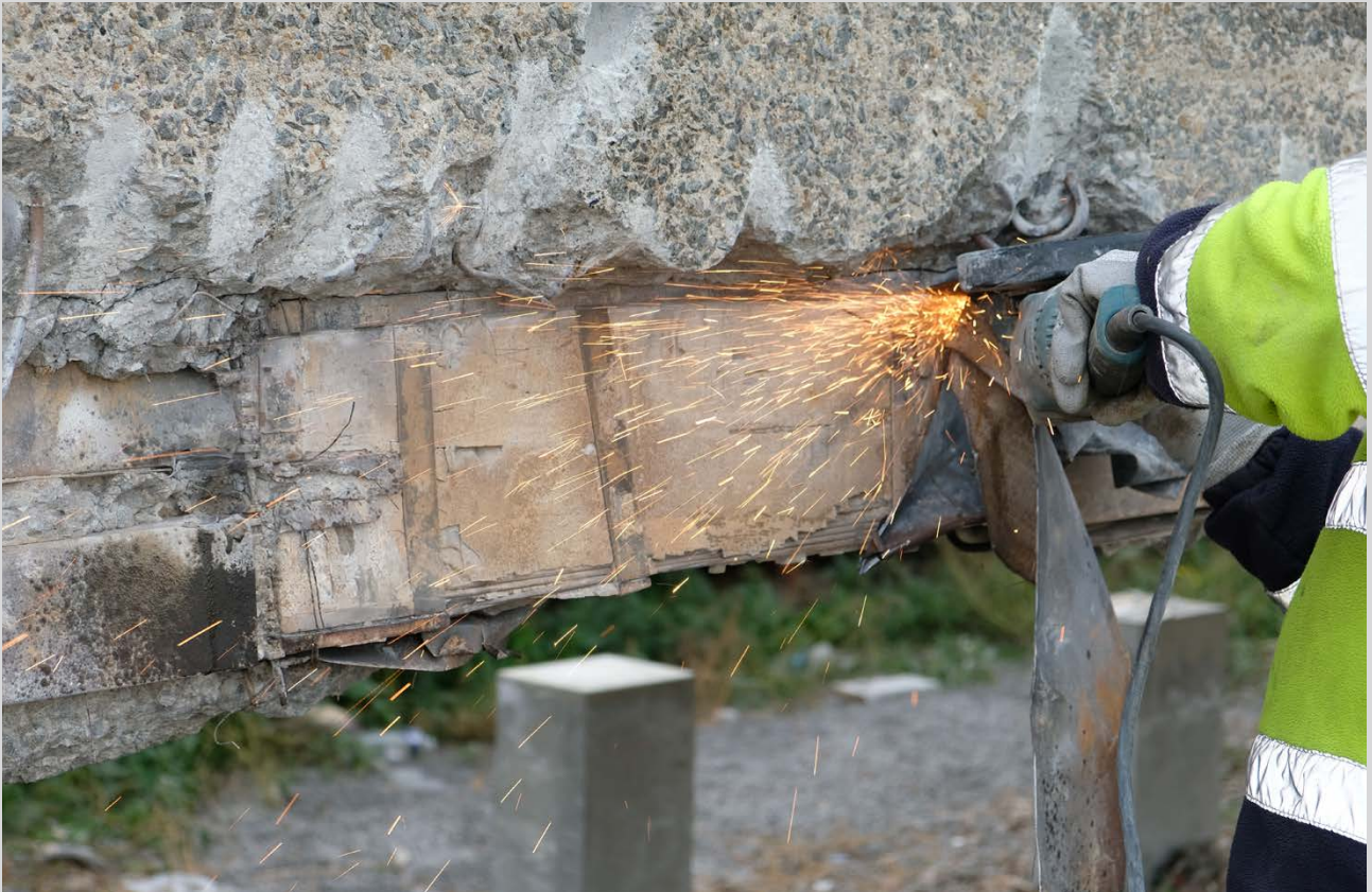
Doorgezaagde metalen behuizing in het centrale deel van een van de liggers na verwijdering van de betondekking.
