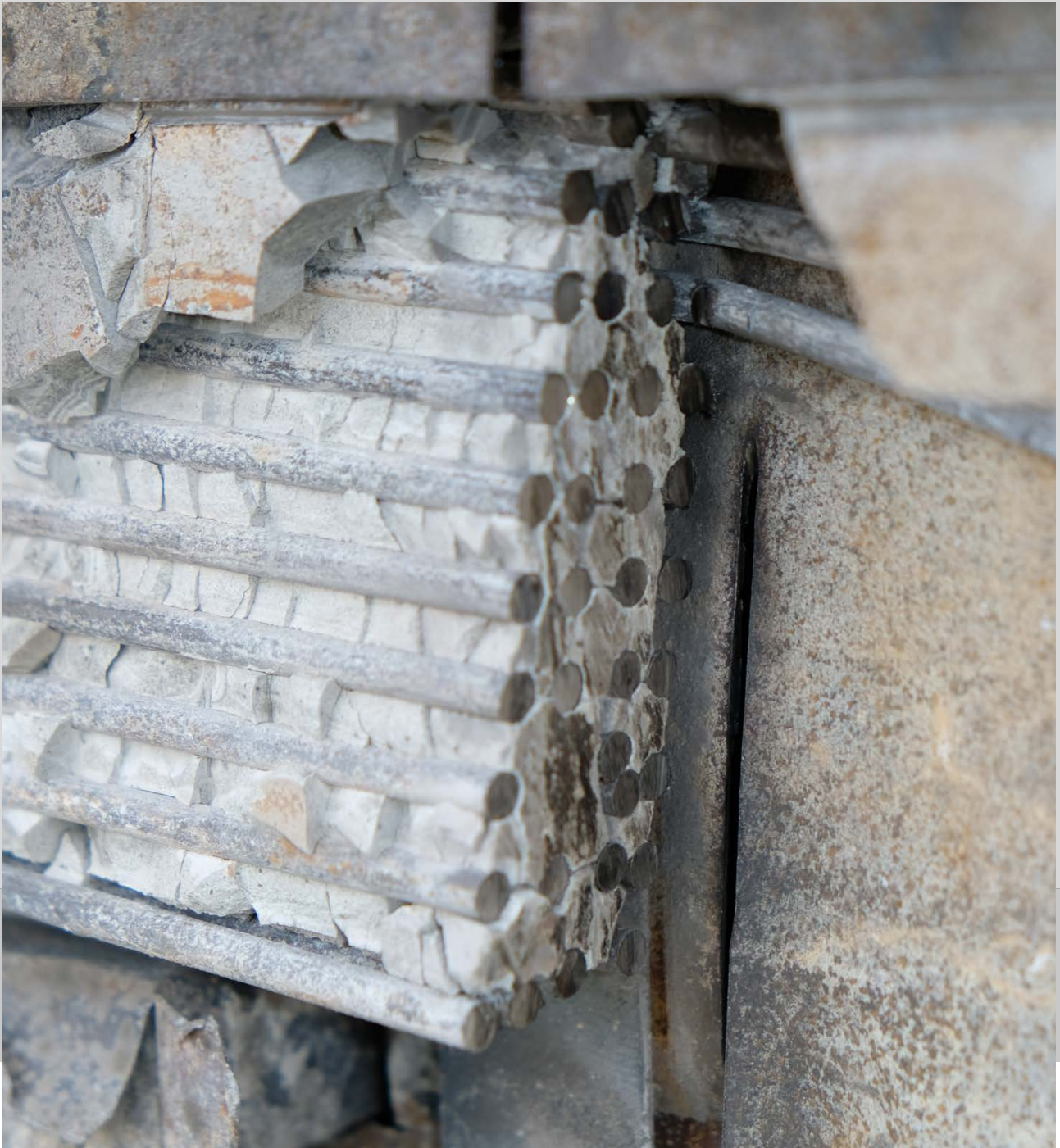
De doorgezaagde voorspankabels in het centrale deel van een van de liggers. Let op de cementmortel die gebruikt werd om de wapeningskabels te beschermen en de perfecte staat waarin deze zijn bewaard.
