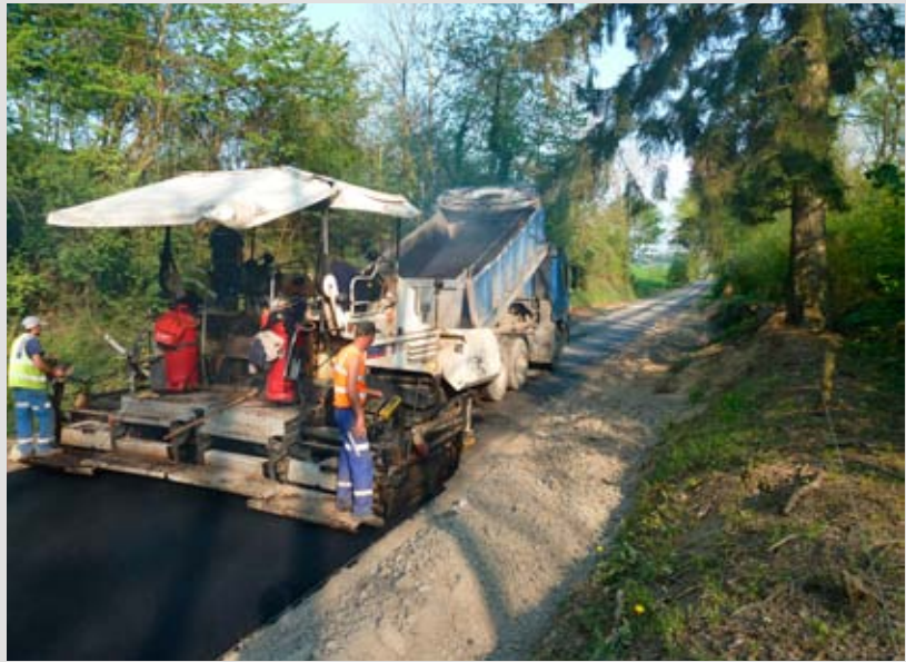
Een asfaltbekleding vormt de verbindingslaag tussen de bestaande weg en de nieuwe betonplaat. Deze zorgt voor een goede hechting tussen de fundering en de bekleding. De funderingen zijn ook verbreed om de nieuwe plaat over een breedte van 4,5 meter te dragen.
