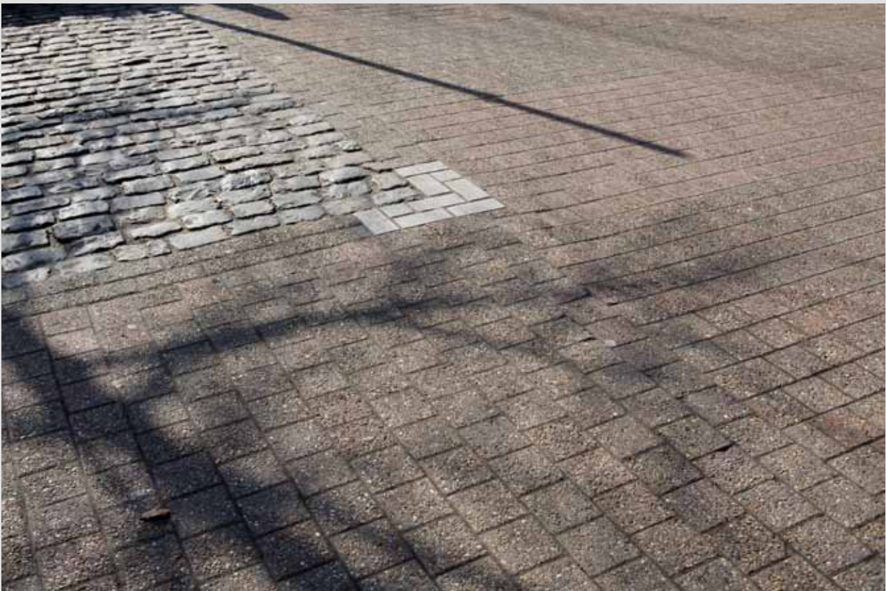
De combinatie van kasseien en betonstraatstenen, een wekerend beeld in het Aarschotse stadscentrum, zoals dit voorbeeld op het Schaluin
