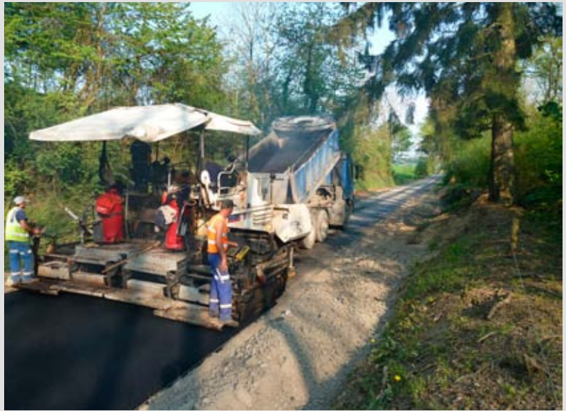
Une couche de liaison entre la voirie existante et la nouvelle dalle en béton est réalisée en revêtement hydrocarboné. Elle assure la bonne adhérence entre la fondation et le revêtement. Les fondations sont également élargies afin de supporter la nouvelle dalle sur une largeur de 4,5 m.
