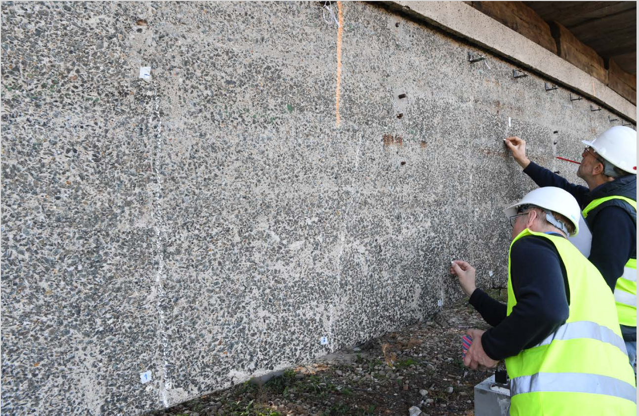
Tracé à la craie des fissures sur la face latérale d'une des poutres.
