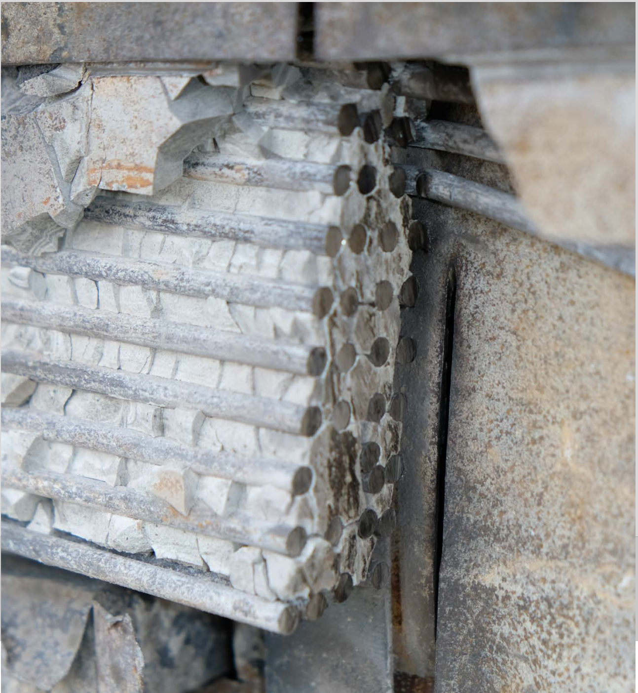
Les fils de précontrainte coupés dans la partie centrale d'une des poutres. A noter le coulis de ciment de protection des fils et le parfait état de conservation de ceux-ci.
