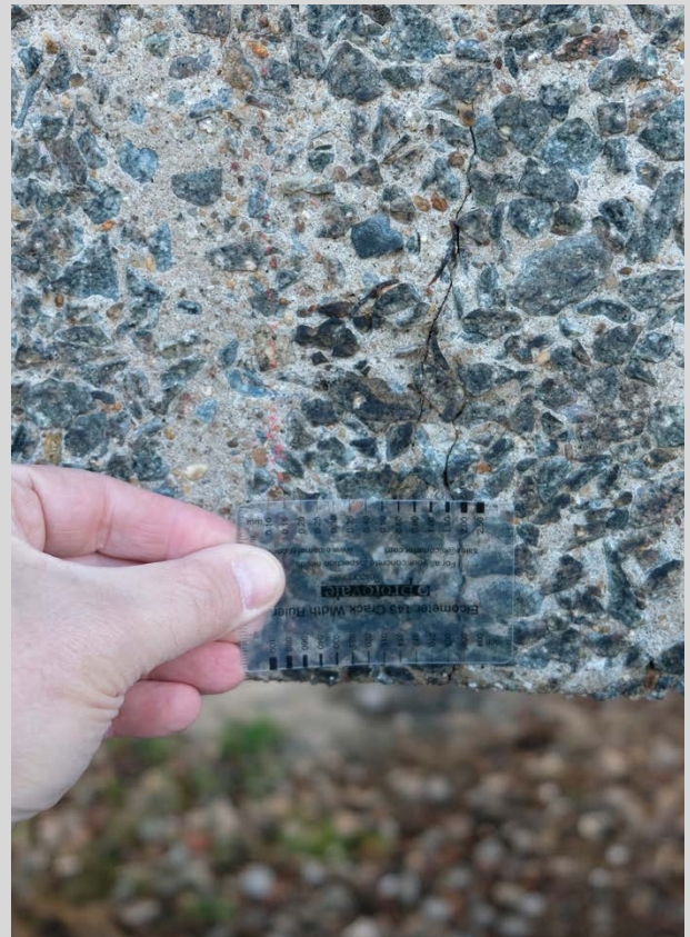
Fissure dans le béton à la partie inférieure d'une poutre de la passerelle, à mi-portée sous poids propre. Son ouverture (0,8 mm) est appréciée au moyen d'une jauge de comparaison.
