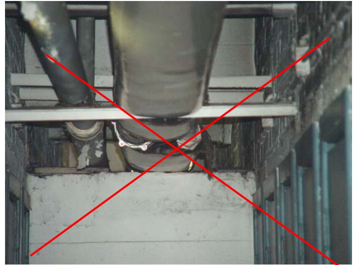
Niet doorgemetselde muur in een wand met EI-eis, ter hoogte van de doorgang van verwarmingskokers (bron [8])
