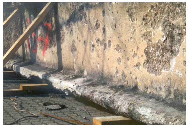
Afgesprongen beton bij de hoofdbalken (bron : FEBELCEM).
