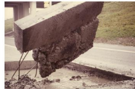
1987, E411, Courrière-Custinne, herstelling van een dagvoeg. Het poreuze, slecht verdichte beton is duidelijk zichtbaar aan één zijde van de voeg.
