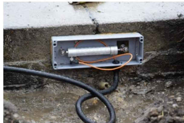
Bild 5: Messsystem zu Ermittlung der Fugenbewegungen
